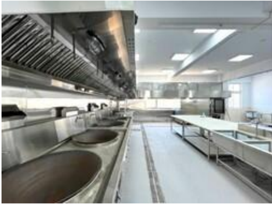
圖：金門縣烈嶼國中廚房內部設備
